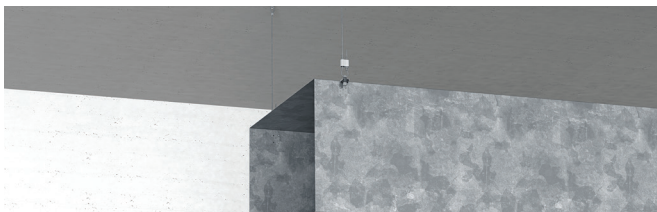
HVAC – rechthoekig kanaal
