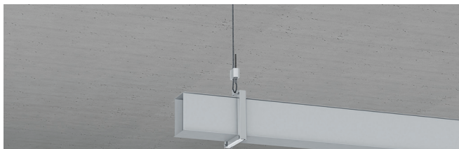
Elektrisch - railsysteem elektriciteit
