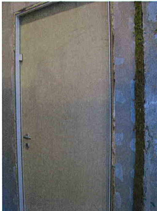
Le jeu entre l' hubriserie de la porte 2 et la cloison est comblé de mousse monocomposant 'HILTI CF-1750/B2' [3].
