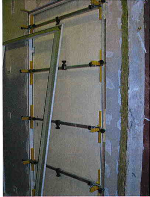
L'hubriserie de la porte 2 est collé à la cloison à l'aide de mousse bicomposants 'HILTI CF 101' [2] sur toute la largeur de l'encadrement et sur une distance de 300 mm au niveau de ses deux montants verticaux à hauteur de chaque charnière.
