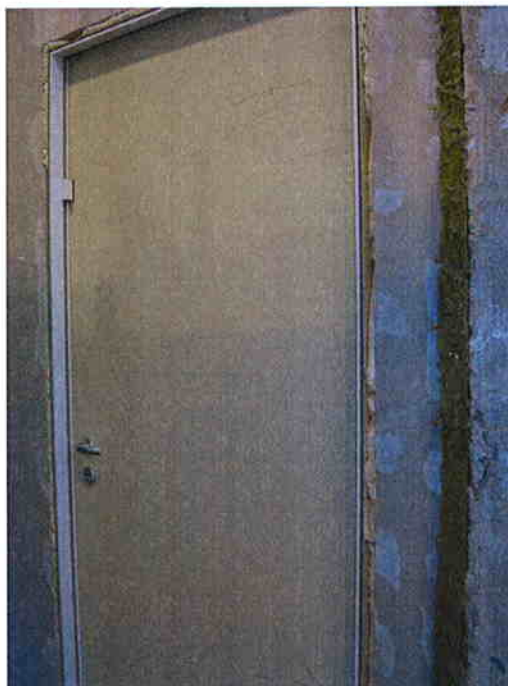
De speling tussen de omlijsting en de wand van deur 2 rondom volledig opgevuld met 'HILTI CF-I750/B2' 1 componentenschuim [3].
